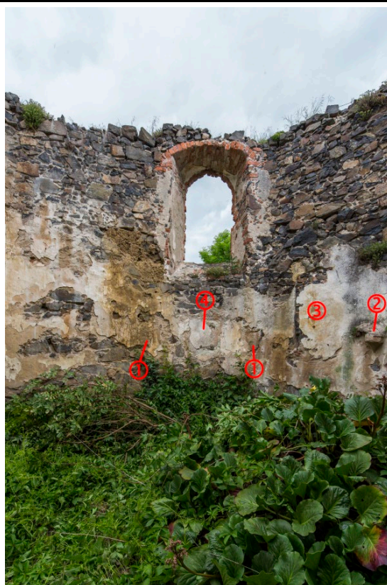
Severní a severovýchodní strana presbytáře v pohledu od jihu. 1) odsekané konzoly, 2) dochovaná severovýchodní konzole, 3) zalděný severovýchodní okenní otvor, 4) zalděný výklenek sanktuária. Foto: Marta Pavlíková 2019.
