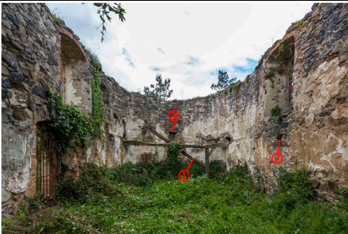
Pohled do interiéru lodi směrem k západu. 1) torzo trámové konstrukce kruchty dendrochronologicky datované do roku 1608, 2) kapsa pro zavázání trámu zaniklého severního ramene kruchty, 3) štěrbinové okénko v ose západní ho závěru, které se snad váže k prvotní tribuně. Foto: Marta Pavlíková 2019.
