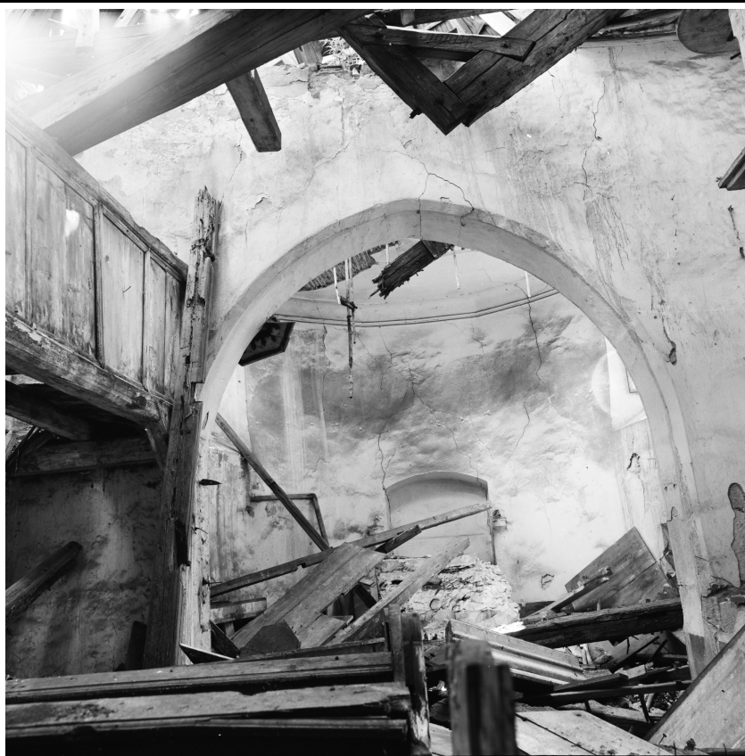
Vítězný oblouk v pohledu od západu. Foto: 1982, sbírka negativů NPÚ ÚOP v Ústí n. L., sign. 67528.
